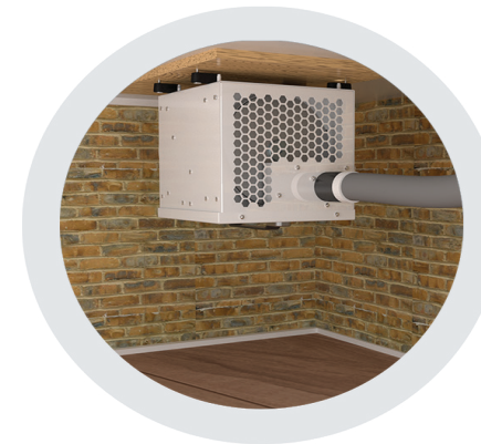
• in einem Kellerraum
